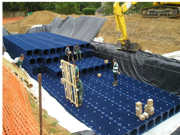
Bassin en caissons WAVIN – Lotissement à Chatillon sur Loire ( Safège Orléans)
